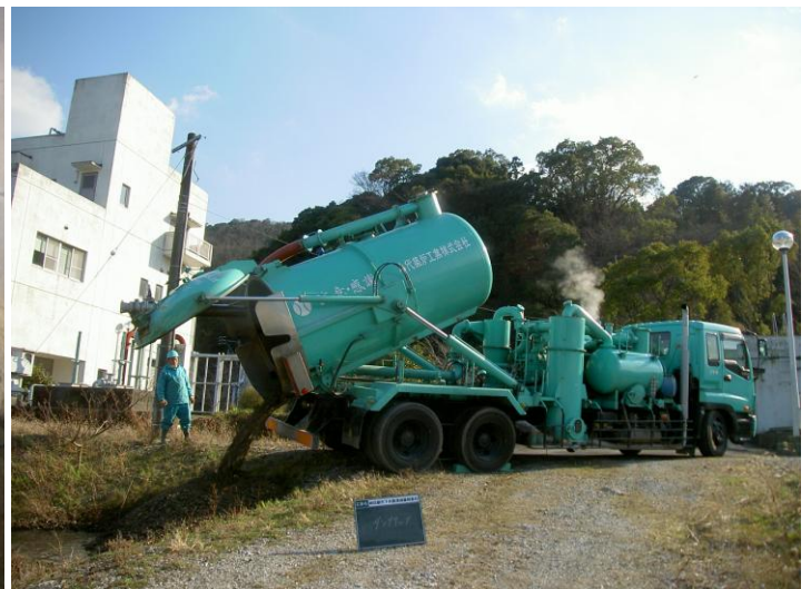
吸引土砂捨状況
