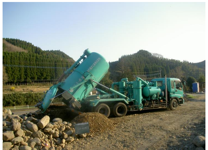
吸引土砂捨状況
